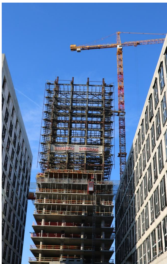
Fot. Unity Centre, źródło: STRABAG
